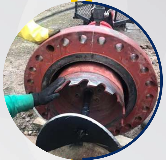
DOS HOT TAPS EN 20 PULGADAS – INSTALACION DE BY PASS - ESTACION MIRAFLOREZ - TGI - ISMOCOL DE COLOMBIA - AGOSTO 2019
