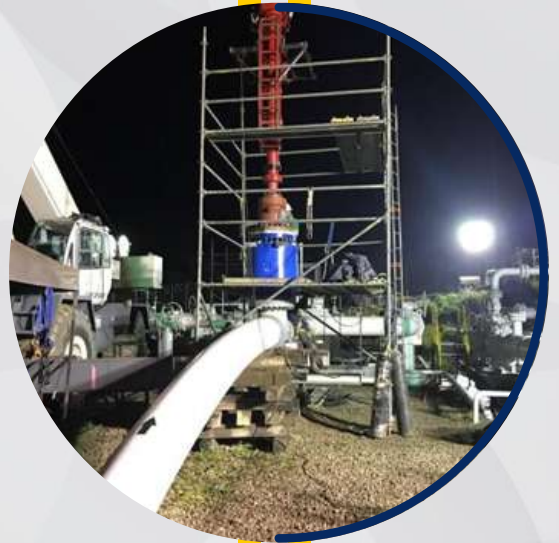
DOS HOT TAPS EN 20 PULGADAS – INSTALACION DE BY PASS - ESTACION MIRAFLOREZ - TGI - ISMOCOL DE COLOMBIA - AGOSTO 2019
