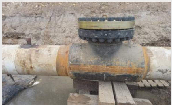
CIEGO INSTALADO CON SU RESPECTIVO TORQUEO Y EMPAQUE
